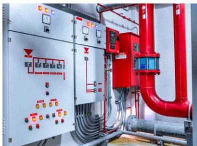
سیستم اعلام و اطفاء حریق ▲
